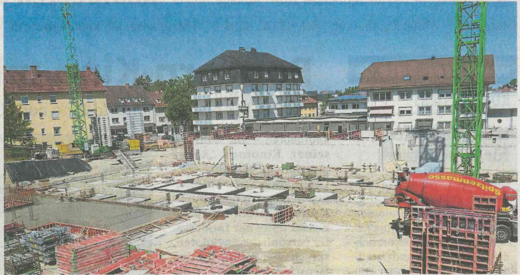
Größtes GSW-Projekt: Der Baufortschritt für den „Generationencampus#Kleeblatt“ an der Falkenstraße ist praktisch täglich sichtbar. Foto: Becker
